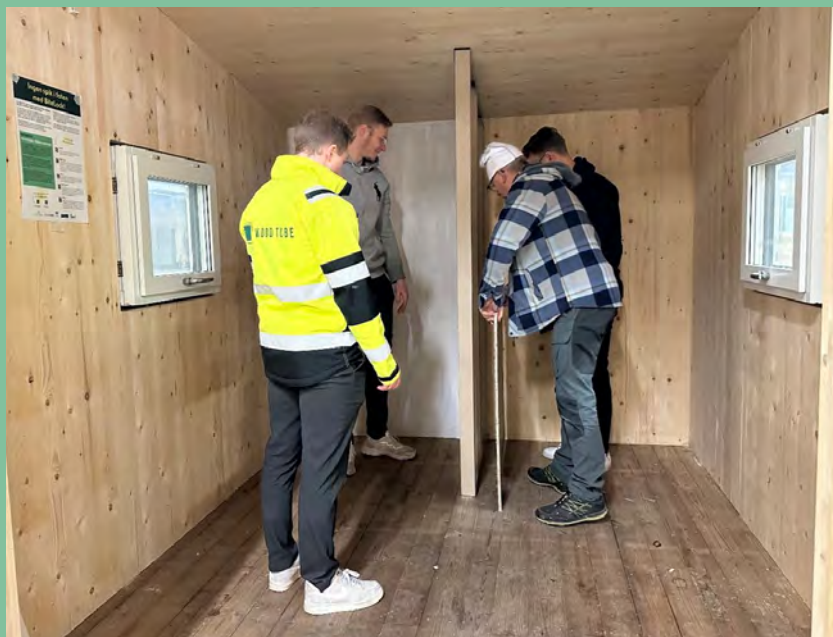
Woodtube, Woodbe och Eld & Vatten installerar sina produkter i innovationsstugan.
